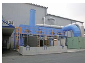
▲薬液洗浄装置
