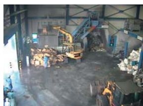
▲②破碎施設
