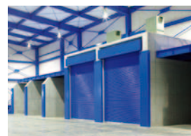
▲シャッター付保管ヤード
